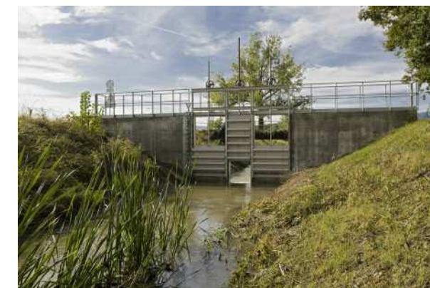
Vannes mobiles régulant les marais de Sionnet et du pré de l'Oie.
